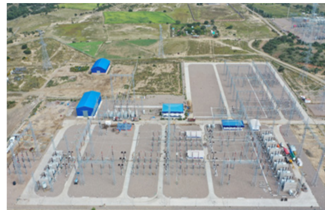
Subestación Santivañez 500 kV
